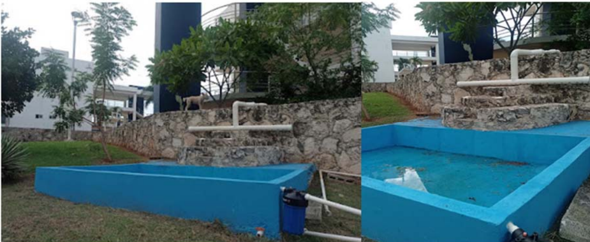
Figura 17 Vista frontal del sistema de captación de agua lluvia.
